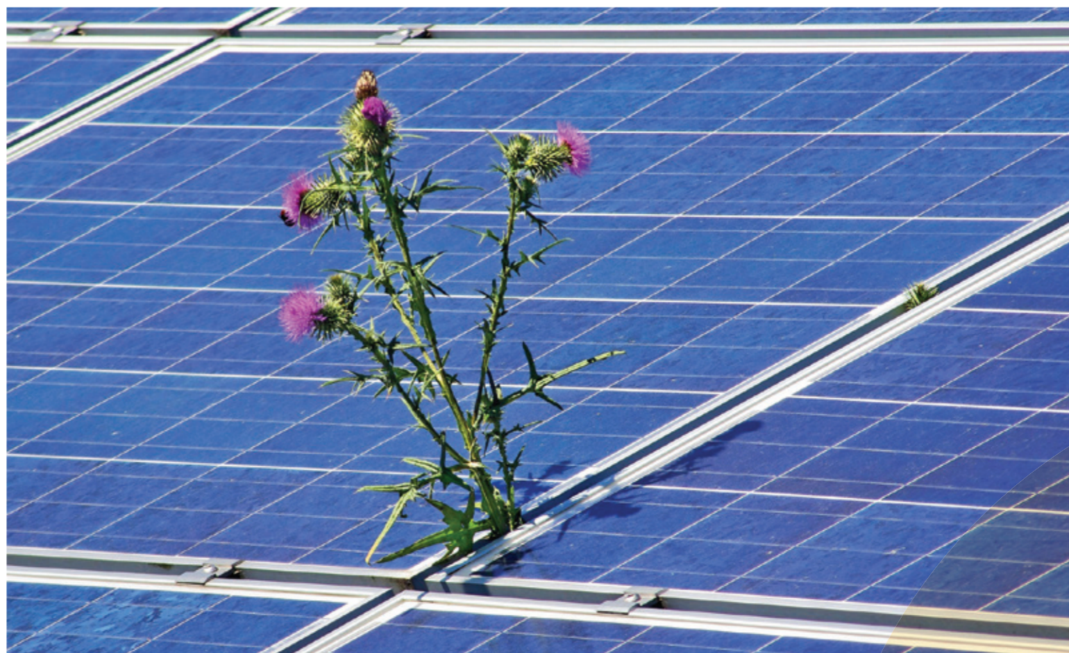
Solarmodule sind dezentral und fördern die Energieunabhängigkeit.
