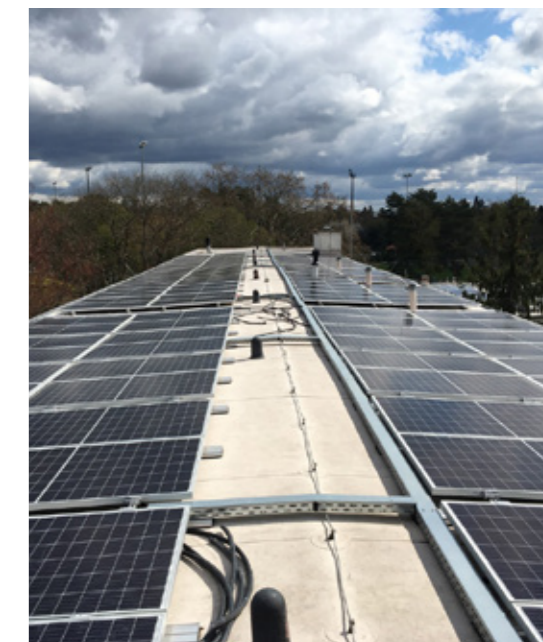
Solarmodule auf dem Schuldach
